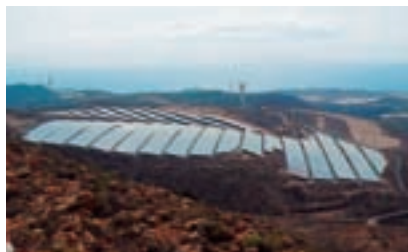
太陽光発電設備（スペイン）
